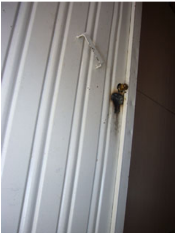
Die aufgebrochene Tür
